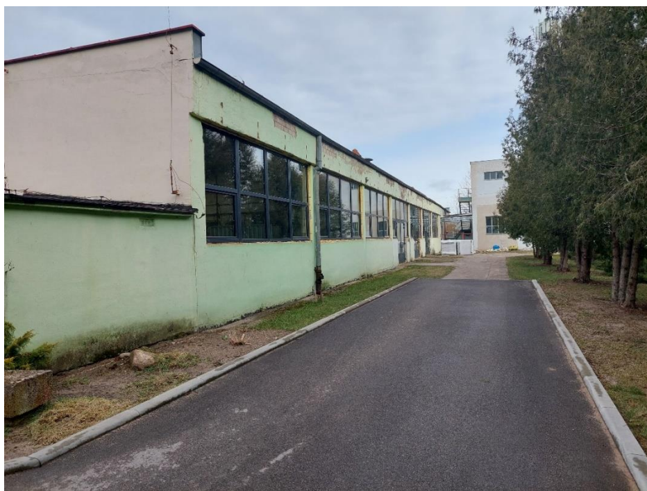
Fot. Starostwo Powiatowe w Pieszu Poprawa efektywności energetycznej budynku Warsztatów Szkolnych Zespołu Szkół Zawodowych z Biblioteką Pedagogiczną w Pieszu – w trakcie realizacji (marzec 2022 r.)
