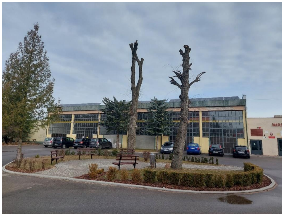
Fot. Starostwo Powiatowe w Pieszu Poprawa efektywności energetycznej budynku Warsztatów Szkolnych Zespołu Szkół Zawodowych z Biblioteką Pedagogiczną w Pieszu – w trakcie realizacji (marzec 2022 r.)
